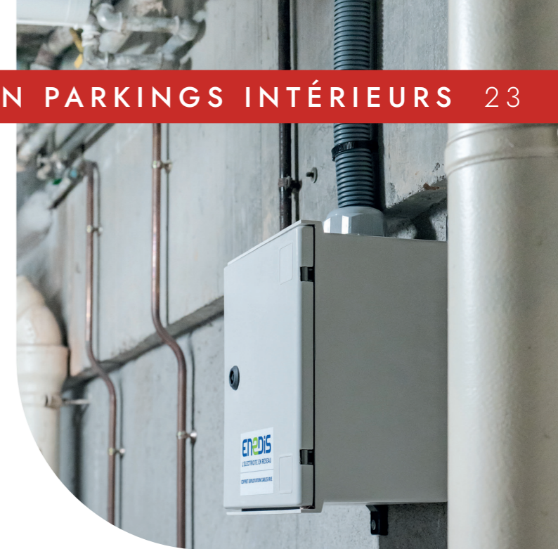
Exemple de coffret d'exploitation
