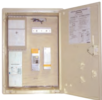
Coffret de branchement provisoire monophasé (P490 - P489)
