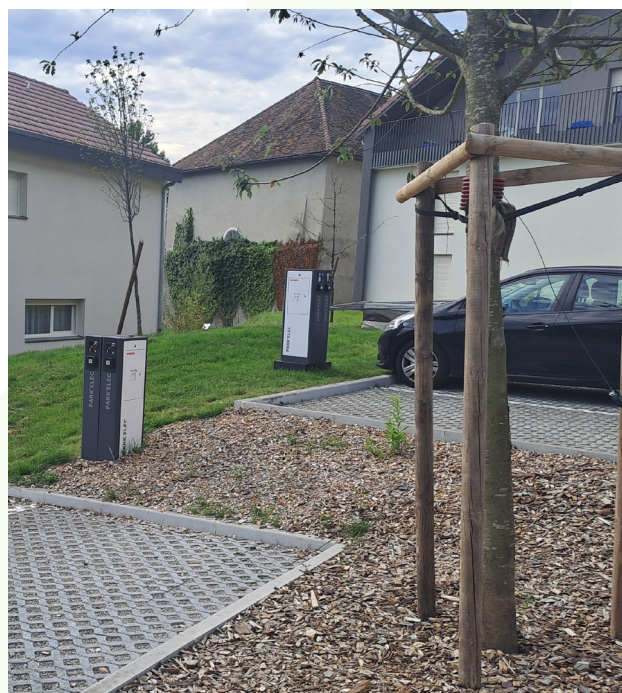
Exemple de desserte en souterrain (ParkTotem 7 Michaud)
